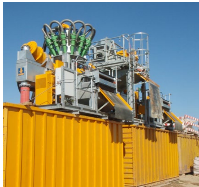
Separationsanlage, Lissabon, Portugal
